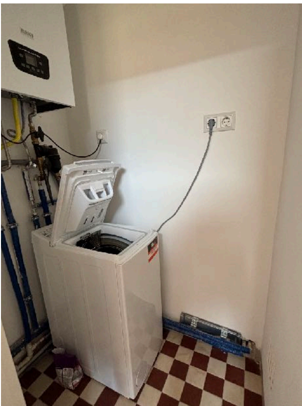
Abstellkammer (Heizung und Waschmaschine)
